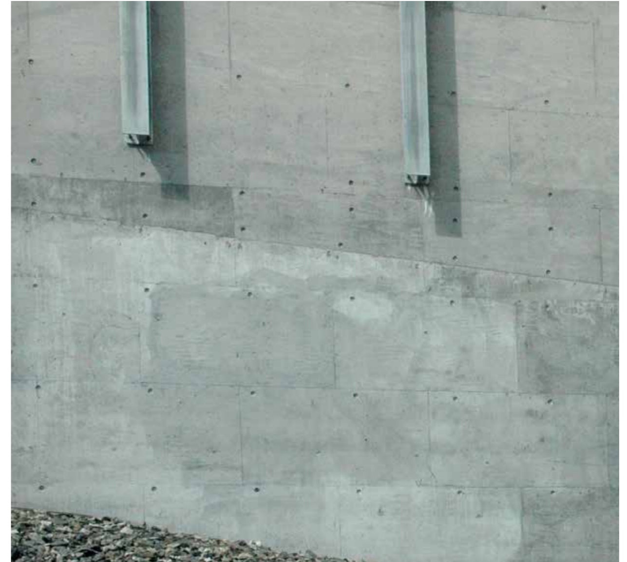
3 BUD - Mangelfull rengjøring av forskaling og slurvete påføring av formolje skaper variasjoner i gråfargen.
