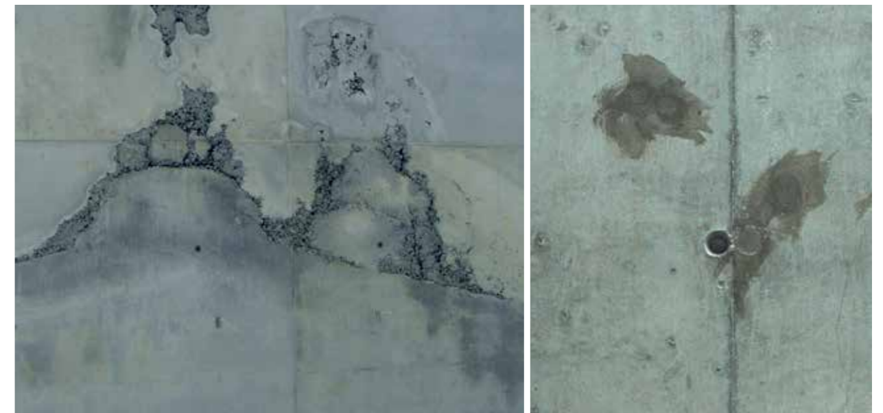
5 BUD - Feil konsistens på betongen medfører separasjon. 8 BUD - Bruk av feil reparasjonsmørtel fremhever skaden i stedet for å skjule den.
